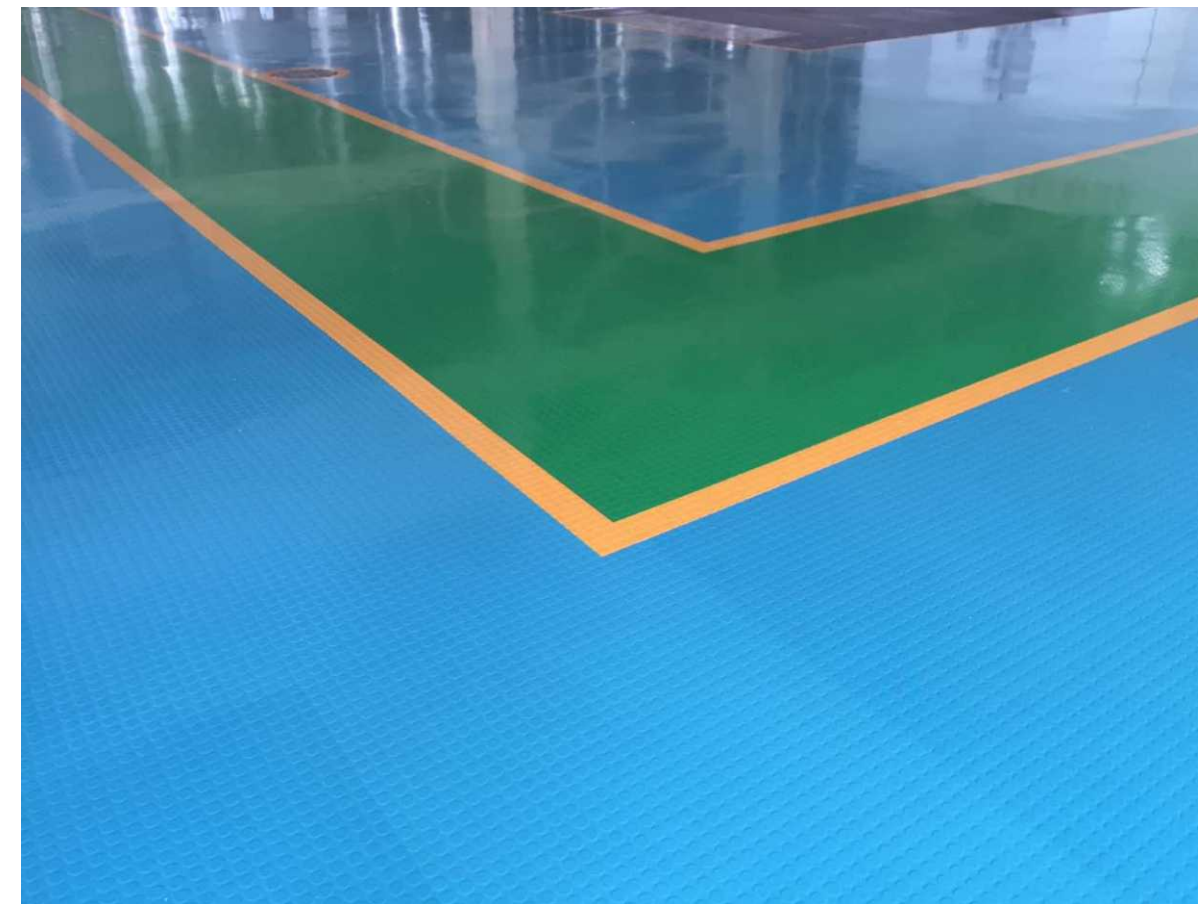
陕西蒲城电厂 SHAANXI PUCHENG POWER PLANT ► 年份：2016年 ► 面积：6,000m 2
